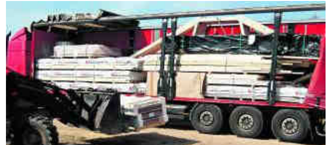
...a w takim stanie przyjechał na plac budowy
